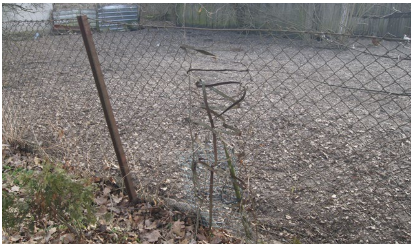
Prowizoryczne naprawy starego ogrodzenia świetlicy w Zwierkach
